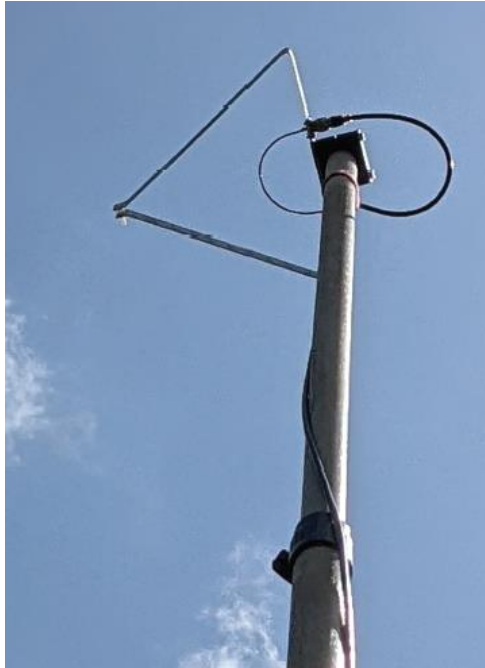
Fot. 4.3.3. Antena zamontowana na maszcie
